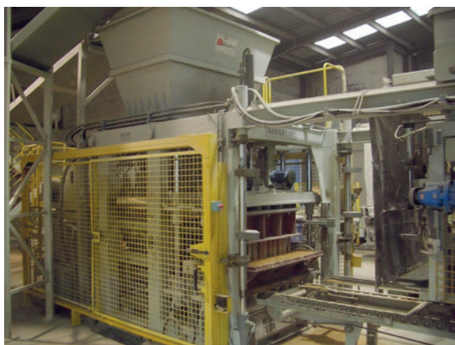
Vue sur l'installation de production à l'usine de La Romera, avec la presse à blocs du constructeur Poyatos
